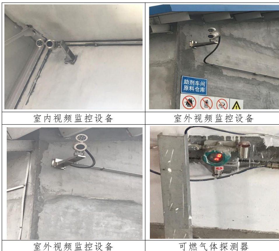
图 3-1 视频监控及可燃气体探测器
